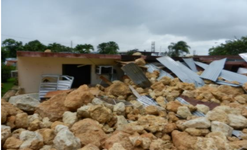
Imagen 2-19: Daños Causados por un Deslizamiento de Terrenos en la Urb. Villa España (Agosto 2013)
