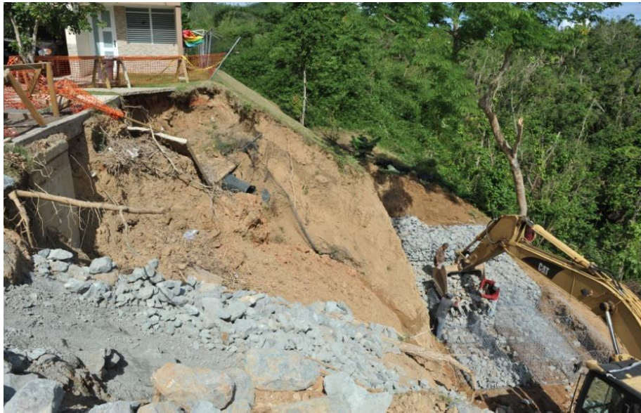
Imagen 2-18: Deslizamientos por Lluvia a Causa del Huracán María
