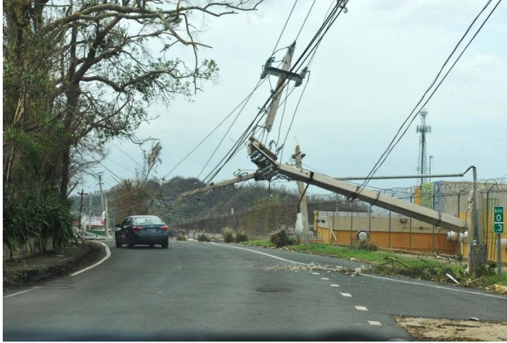
Imagen 2-3: Infraestructura Eléctrica Luego del Huracán María (Sept 2017)
