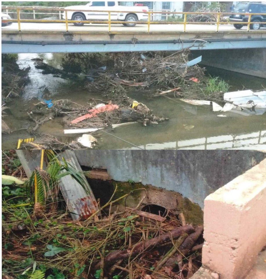
Imagen 2-16: Escombros Arrastrados a los Cuerpos de Agua por Eventos de Lluvias Intensas
