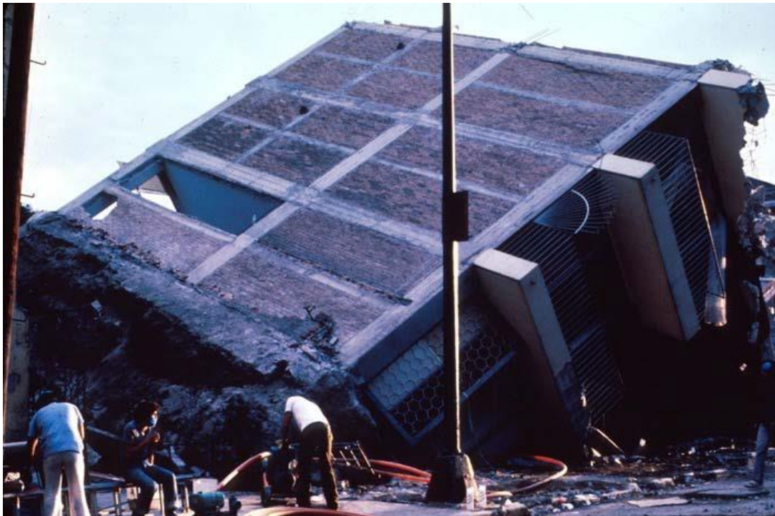
Imagen 2-14: Efecto de Licuefacción Sobre Edificio en México
