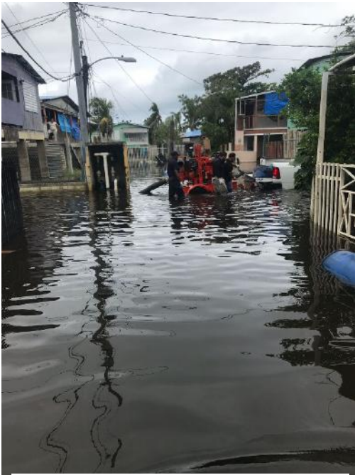
Foto 5: Sistema de Bombas, Calle Amparo, Com. Juana Matos, Cataño
