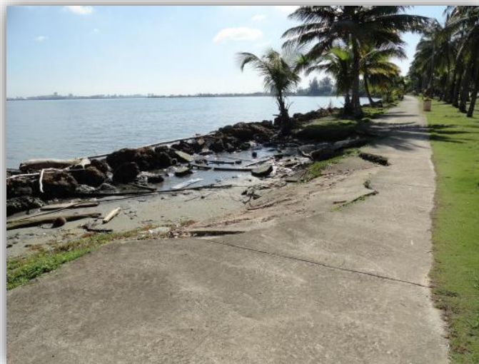
Foto 7: Erosión paseo lineal, Urb. Bay View (H. Rivera-2014)
