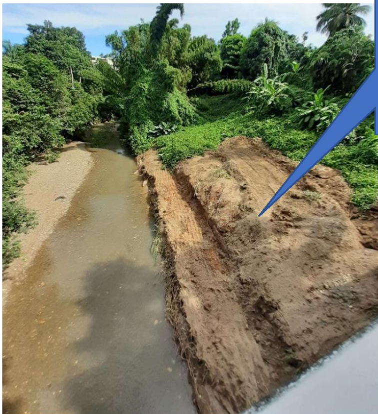
Remoción de corteza vegetal, movimiento de tierra y desestabilización de taludes en el lado Suroeste del puente que da acceso a la entrada principal de Sierra Berdecía en la Calle Alpierre
