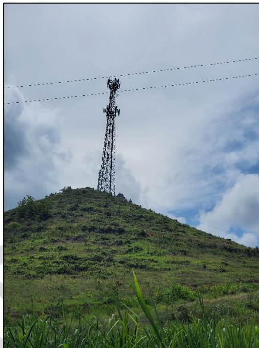
Foto 20. Telecomunicaciones en Patillas
