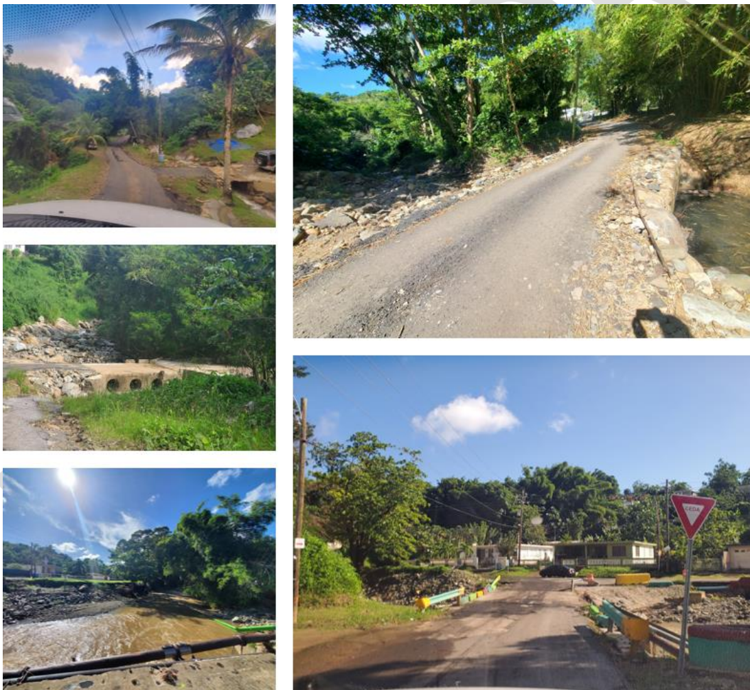
Foto 16. Puentes con deficiencias estructurales en Patillas
