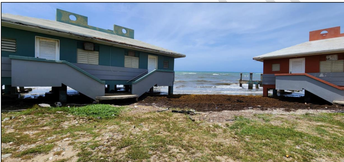
Foto 8. Estado actual de las Villas del Centro Vacacional Punta Guilarte
