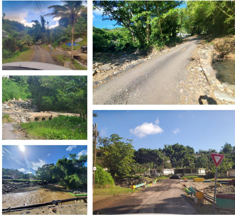
Foto 17. Puentes con deficiencias estructurales en Patillas
