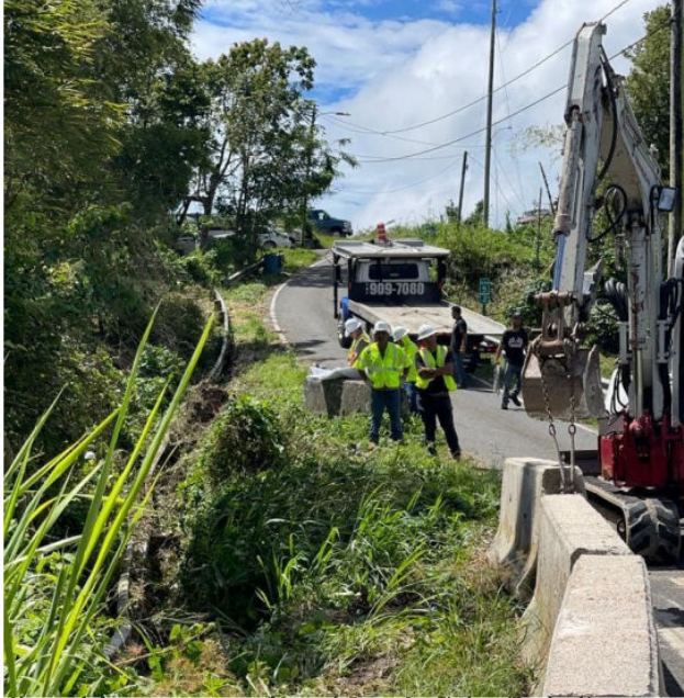
Algunas de las carreteras que sufrieron daños en Las Piedras. (Facebook)
